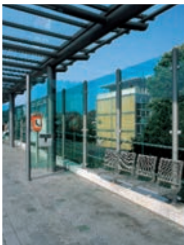
Duisburg, Stadtbahn Rhein-Ruhr: Überdachter Bereich, 2 Jahre nicht gereinigt.
